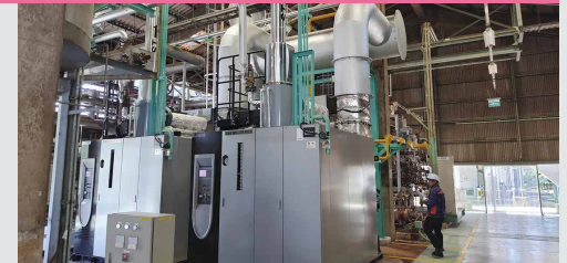
ボイラー（タイ）関西電力
