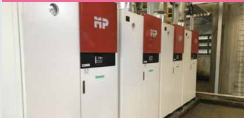
貫流ボイラー（タイ）大阪ガス
