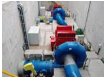
小水力発電(インドネシア) /トヨーエネルギーファーム
