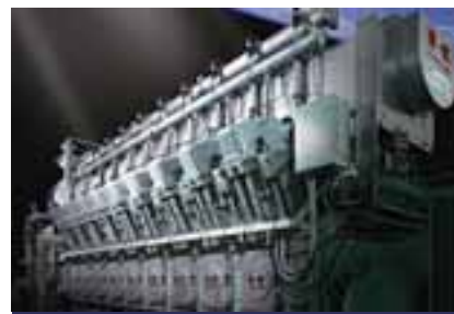
【Co-generation system】 (Thailand)
