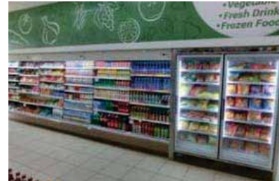
コンビニ省エネ (ローソン) 省エネ設備: パナソニック製
